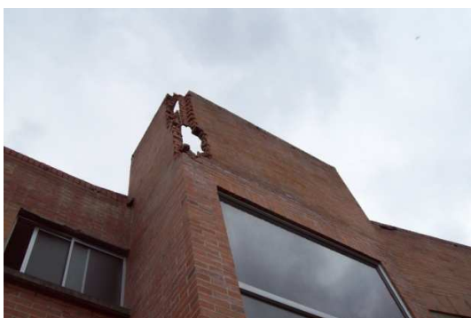
Foto 1. Daños en una vivienda unifamiliar por impacto directo de un rayo.
