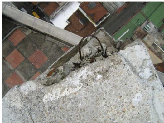
Foto 2. Daños en un edificio por impacto directo de un rayo.
